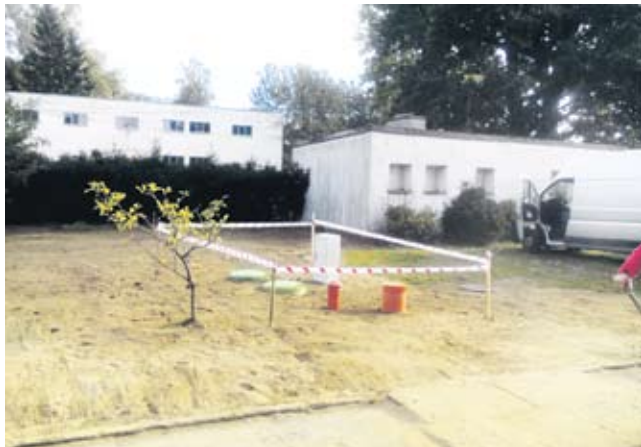
Bardzolino: przydomowa oczyszczalnia ścieków
